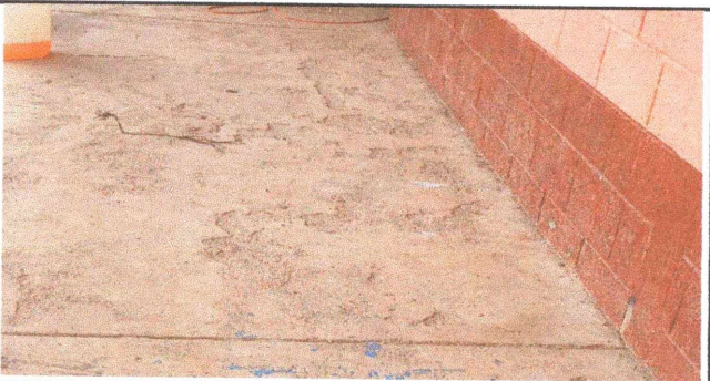
Foto 5: Sustitución de piso por grietas.
